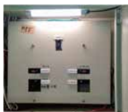
制御盤内の照明
