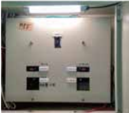
制御盤内の照明
