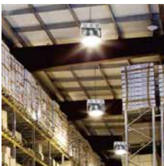
一般倉庫照明
